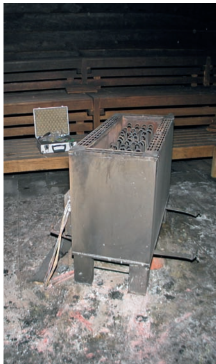
Bild 2 | Eindeutig der Brandausbruchsort – der Saunaofen
