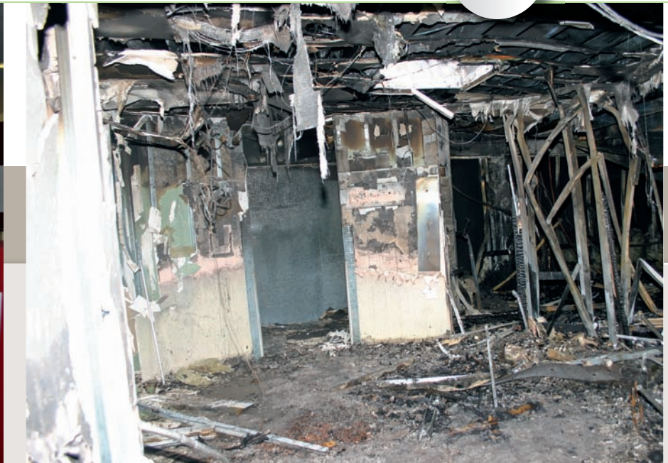
Bild 6 | Vor dem Eingang zum Saunaraum wird das Ausmaß der Zerstörung deutlich.
