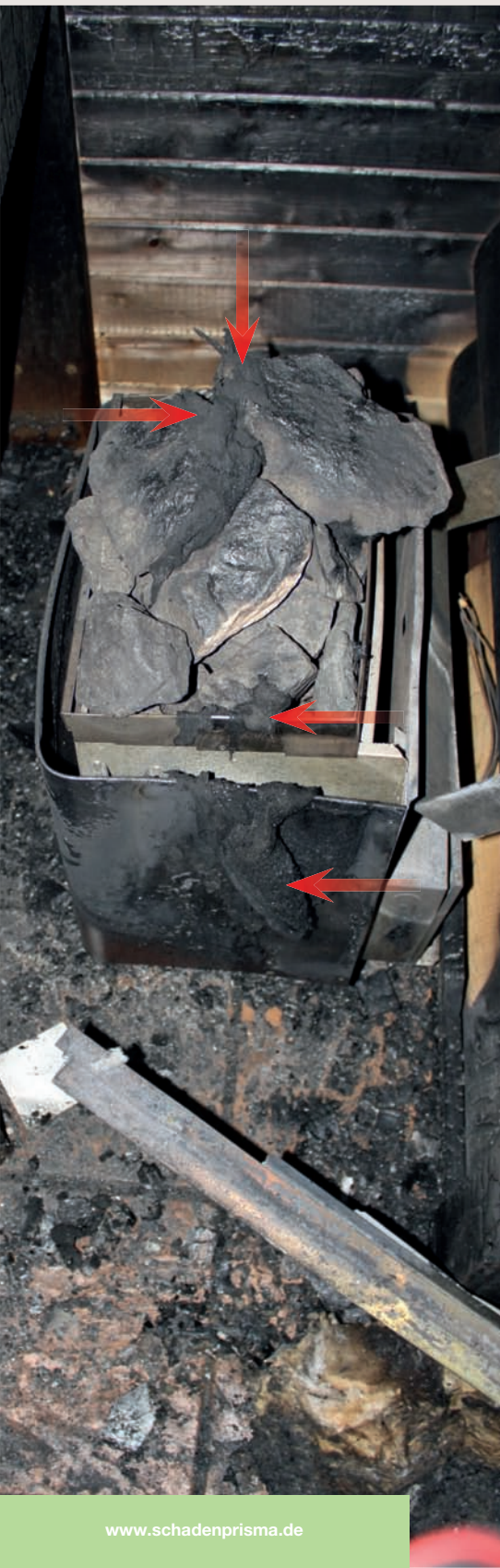
Bild 4 | Von diesem Saunaofen war der Brand ausgegangen. Die Pfeile zeigen auf Reste verbrannter Textilien.
